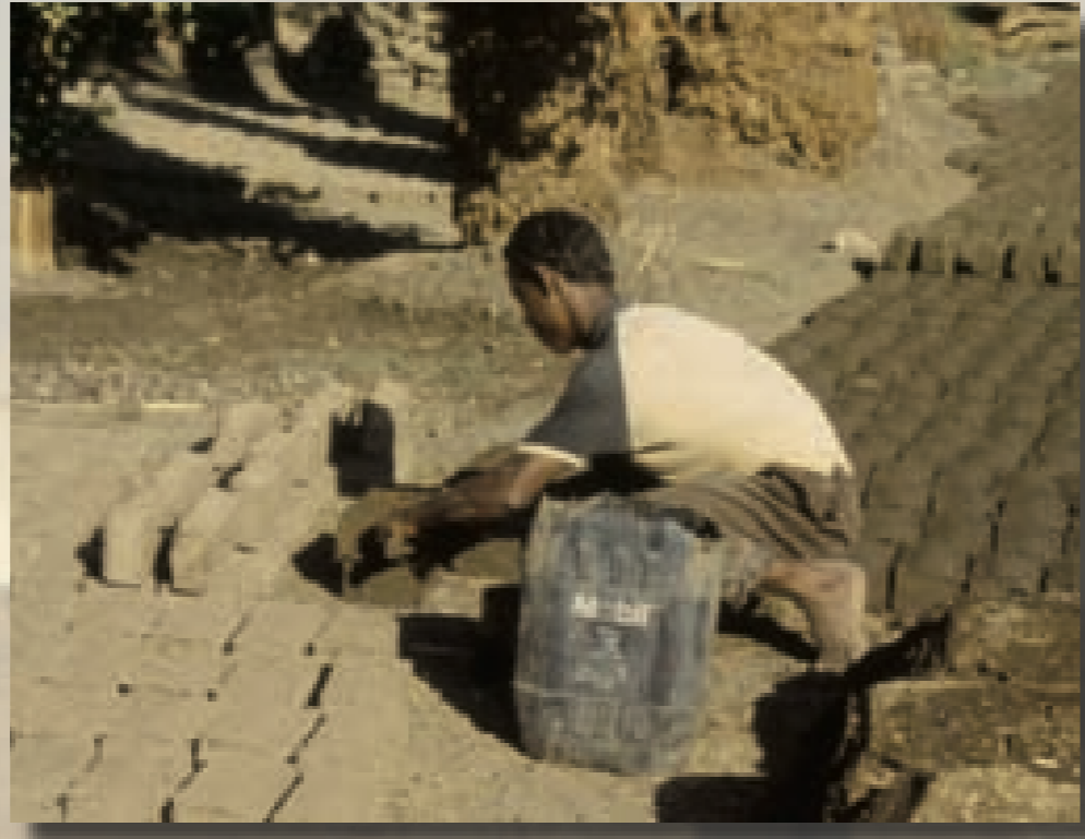
Mud-bricks being made for a house. Fabrication de briques de boue pour une maison.
